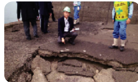
大分港の護岸の老朽化を調査(大分市)
